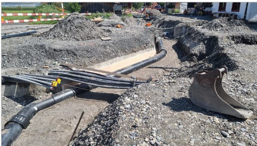
Abwasserdruckleitung Bereich Giessenstrasse Ruggell
